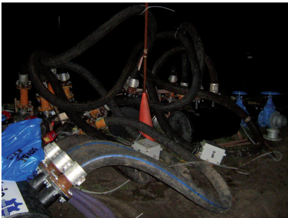
Figuur 3.15 Doorspoelfilters voor zuivering van het kanaalwater
