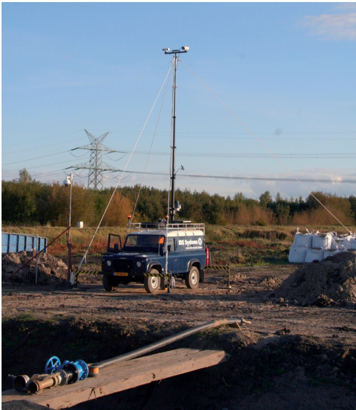
Figuur 5.5.1 Installatie meetopstelling InTech 1
