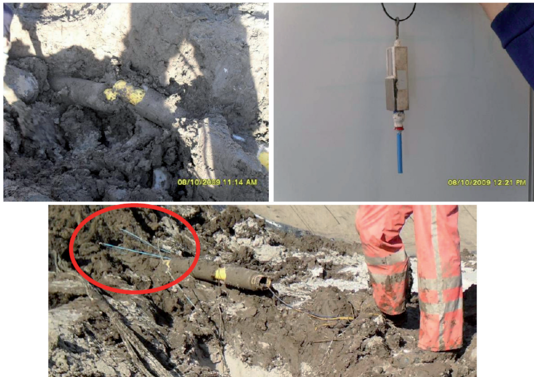
Figuur 5.7.8 A. Gebroken buis (linksboven), B. Afgebroken bekabeling van sensor (rechtsboven), C. Glasvezels staan onder spanning na doorbreken dijk (middenonder)
